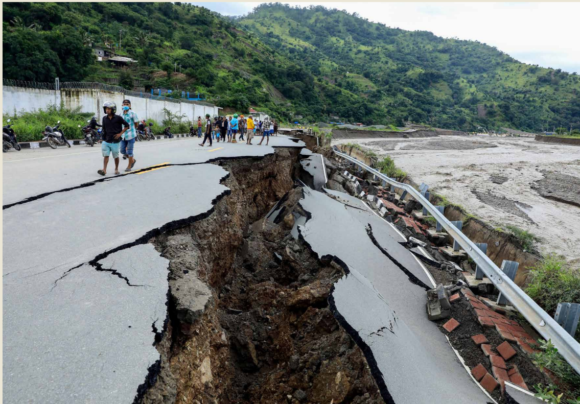
Uma estrada danificada na sequência das inundações em Díli, Timor-Leste, abril de 2021. Dezenas de pessoas morreram e várias ficaram desaparecidas na sequência das inundações e dos deslizamentos de terras causados por chuvas torrenciais que atingiram a parte oriental da Indonésia e Timor-Leste. Foto: Antonio Dasiparu/EPA-EFE/Shutterstock
